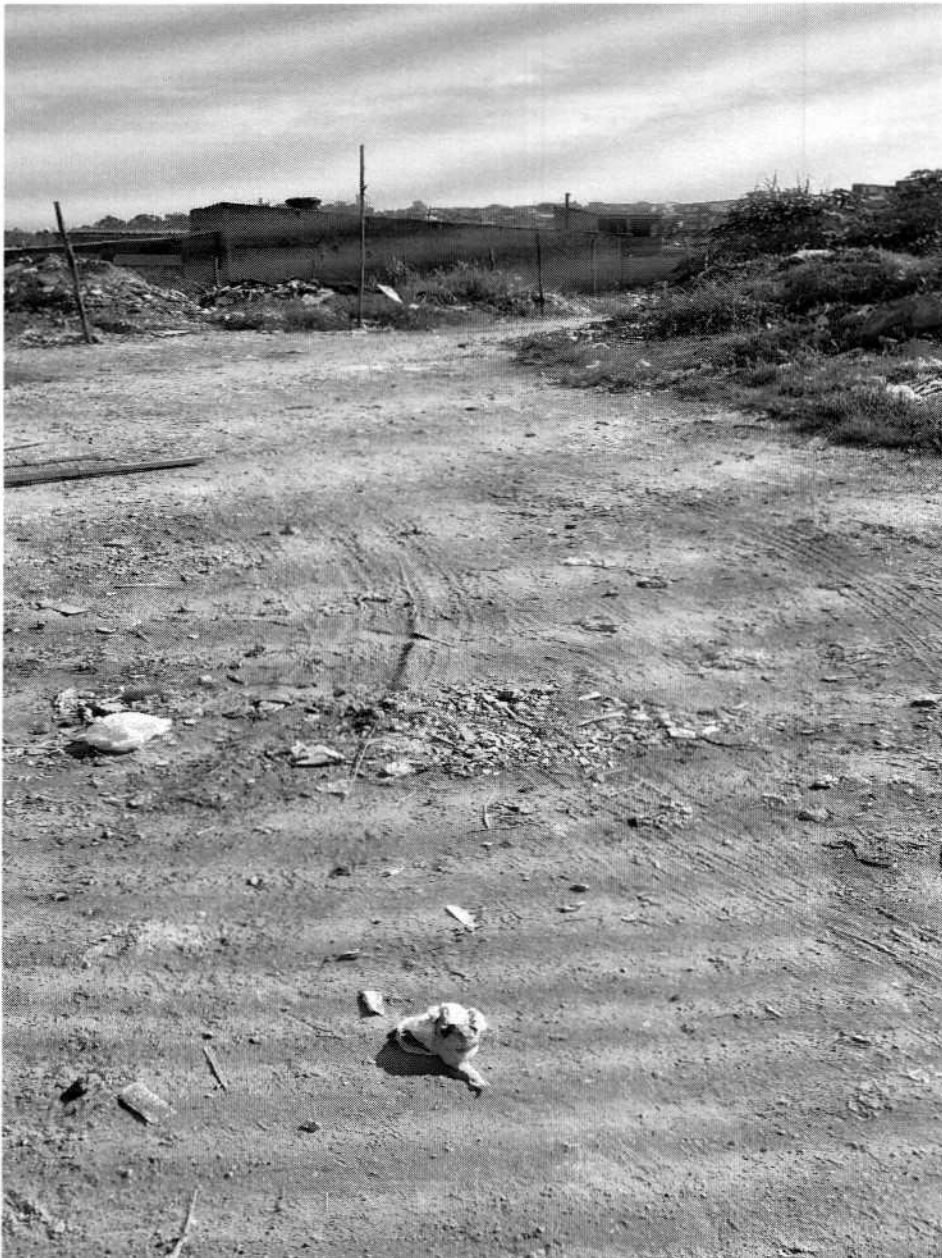
PAVIMENTAÇÃO E IMPLANTAÇÃO DE REDE DE ESGOTO NA RUA GENERAL LOMBO. JARDIM AEROPORTO III MOGI DAS CRUZES.
